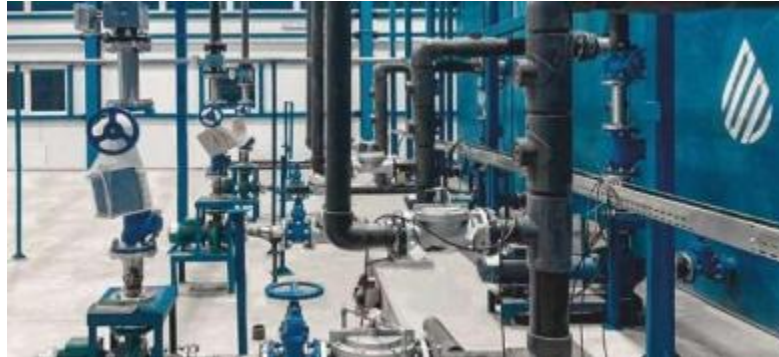
П. КРАСНЫЙ ЯР, ОМСКАЯ ОБЛАСТЬ АО «ЛЮБИНСКИЙ МКК» Станция очистки сточных вод производительностью 1 000 м 3 /сут
