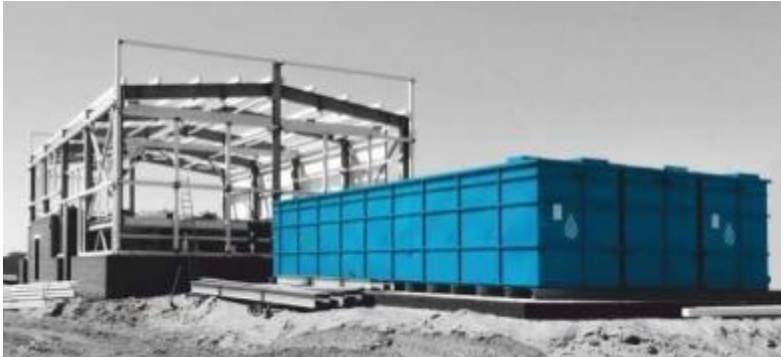
РП. КОЧЕНЕВСКИЙ, НОВОСИБИРСКАЯ ОБЛАСТЬ Оборудование производительностью 2 990 м 3 /сут (Хозбыт, ливневка, промсток)
