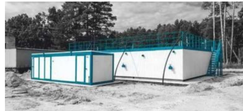
П. КЛЕТНЯ БРЯНСКАЯ ОБЛАСТЬ Станция очистки сточных вод производительностью 600 м 3 /сут
