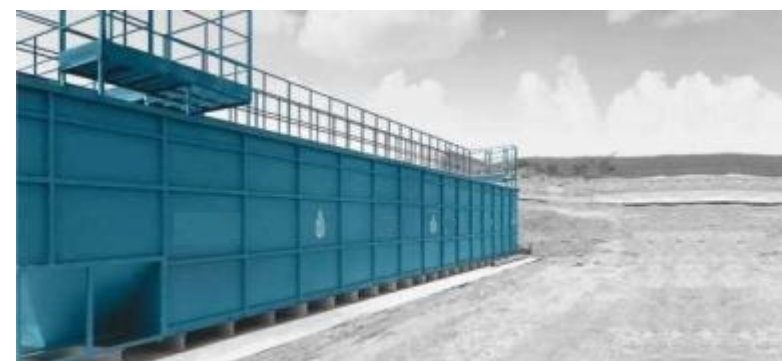
Г. ХЫЗЫ РЕСПУБЛИКА АЗЕРБАЙДЖАН Станция очистки сточных вод производительностью 1 000 м 3 /сут
