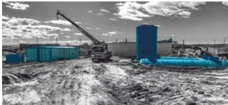
С. МИХАЙЛОВКА ПРИМОРСКИЙ КРАЙ Станция очистки сточных вод производительностью 1 500 м 3 /сут
