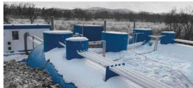
С. ЯКОВЛЕВКА - 1 / ЯКОВЛЕВКА - 2 ПРИМОРСКИЙ КРАЙ Станция очистки сточных вод производительностью 120/500 м 3 /сут
