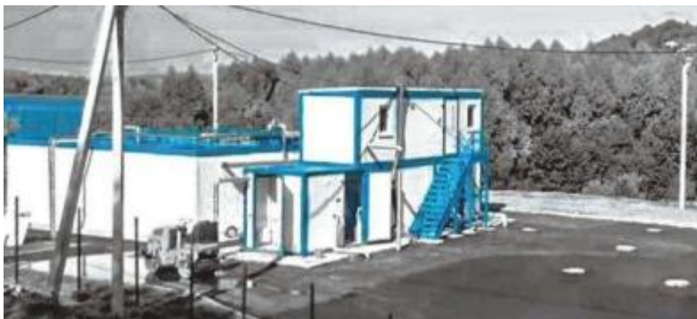
П. ВАСИЛЬСУРСК НИЖЕГОРОДСКАЯ ОБЛАСТЬ Станция очистки сточных вод производительностью 400 м 3 /сут
