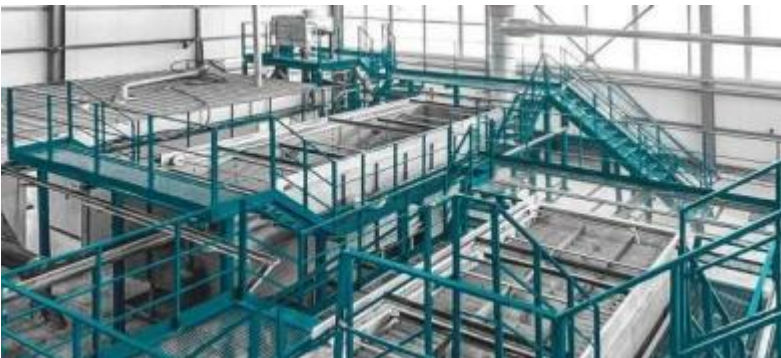
Г. РУЗАЕВКА, РЕСПУБЛИКА МОРДОВИЯ ЯЙЦЕПЕРЕРАБАТЫВАЮЩАЯ ФАБРИКА «РУЗОВО» Станция очистки сточных вод производительностью 600 м 3 /сут
