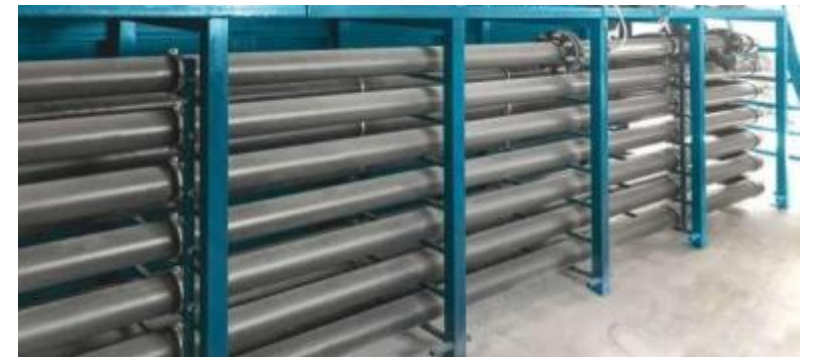
Г. ВОРОНЕЖ, ВОРОНЕЖСКАЯ ОБЛАСТЬ МКК «7 УТРА» Станция очистки сточных вод производительностью 900 м 3 /сут
