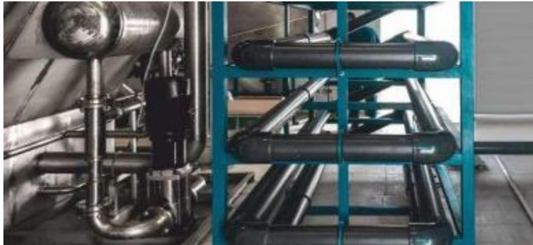
Г. НЕВИННОМЫСК, СТАВРОПОЛЬСКИЙ КРАЙ «КАЗЬМИНСКИЙ» МК Станция очистки сточных вод производительностью 300 м 3 /сут
